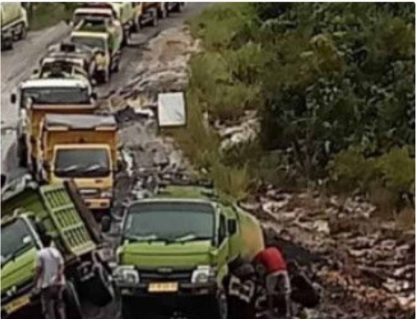
Gambar: Kondisi Ruas Jalan Palangka Raya - Kuala Kurun Beberapa Waktu lalu dengan kondisi rusak oleh angkuta PBS
